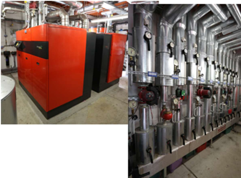
Abb. 10: Heizzentrale Bühl I+II
